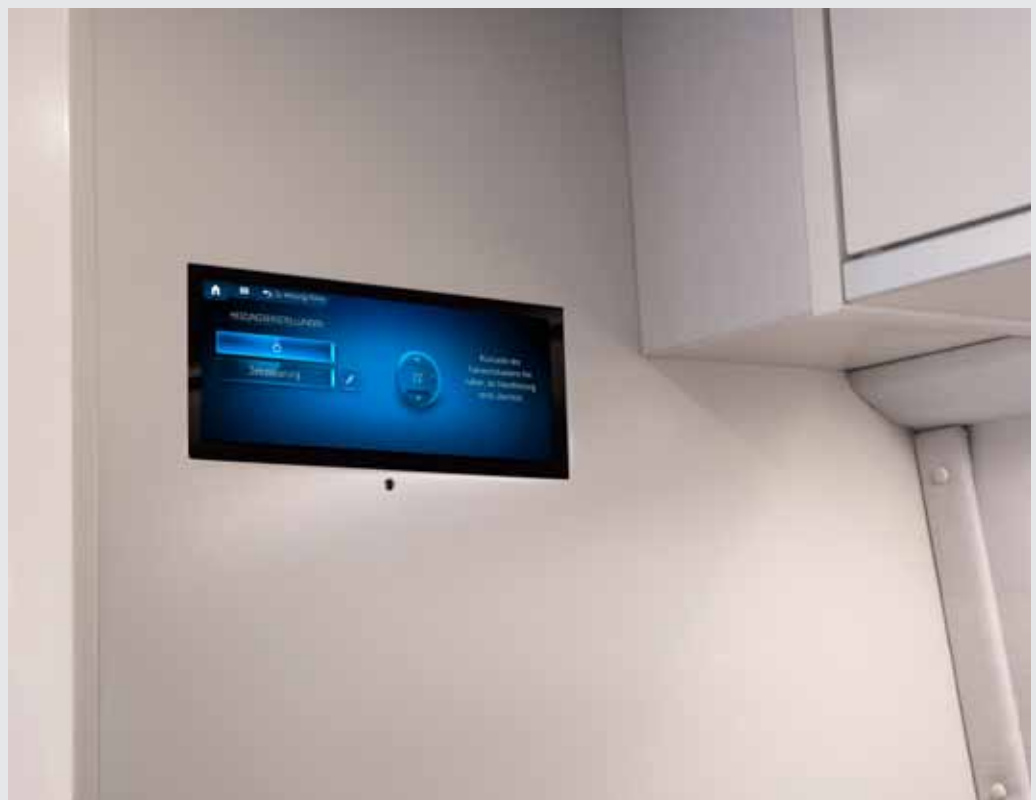
Zentrale Steuereinheit im Wohnbereich
