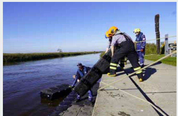
Stegpontons verhindern ein Ausspülen des Flussbettes durch die Druckschläuche der Pumpen. THW/Emanuel Jaschko
