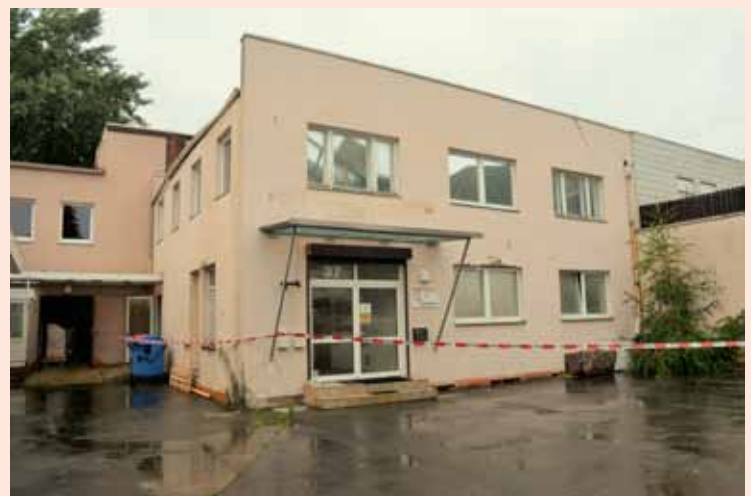
Gebäude mit eingestürztem Dach
